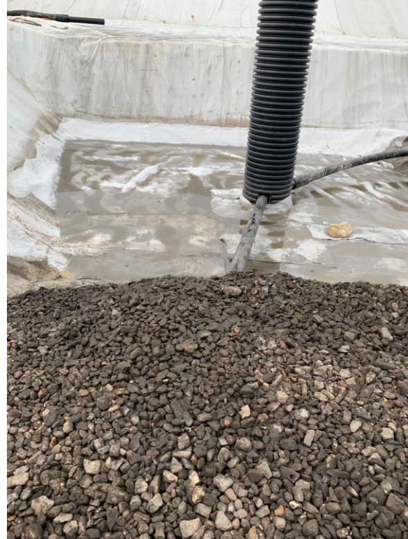
Puits de pompage des lixiviats
